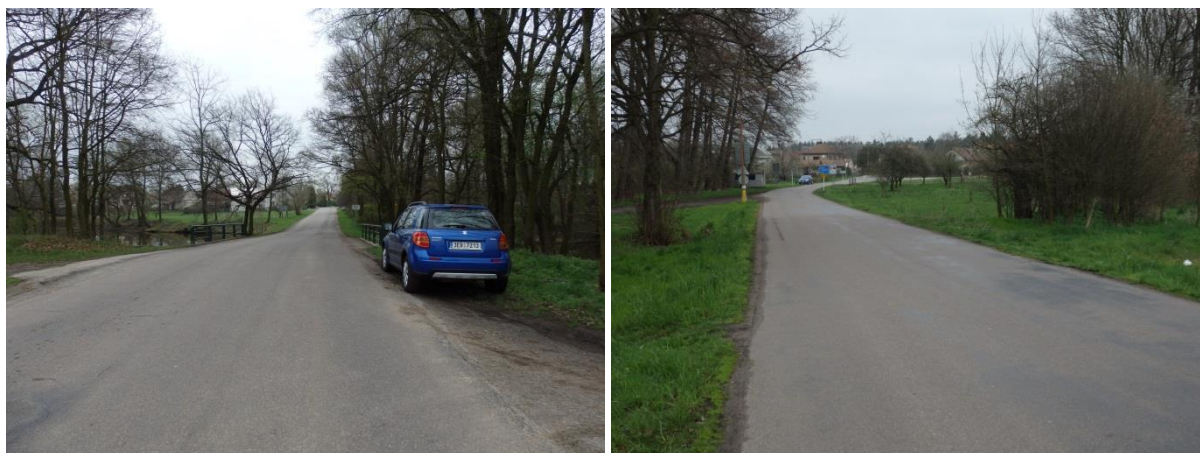
Obr. Často zaplavovaná snížená část silnice mezi Lohenicemi a Přeloučí zaplavovaná od Labe (vlevo) a území mezi Valy u Přelouče a Mělicemi zaplavované od Labe a Živanické svodnice.
